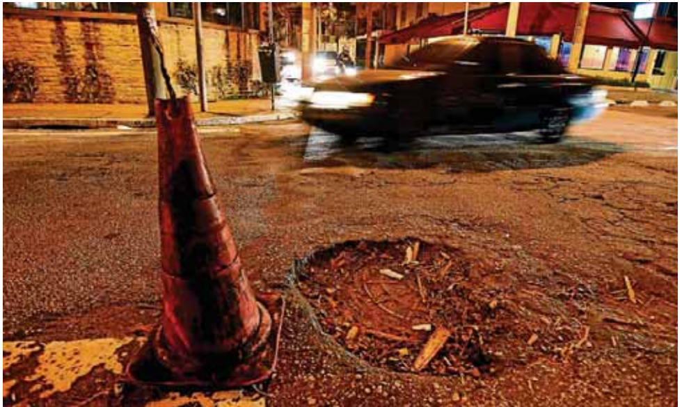
Mais um. Buraco na Rua Pedra Azul no bairro da Aclimação; moradores se queixam de má execução dos serviços
