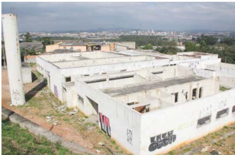
Toda estrutura que cobria a obra da unidade sumiu; acesso ao local é fácil para qualquer pessoa
