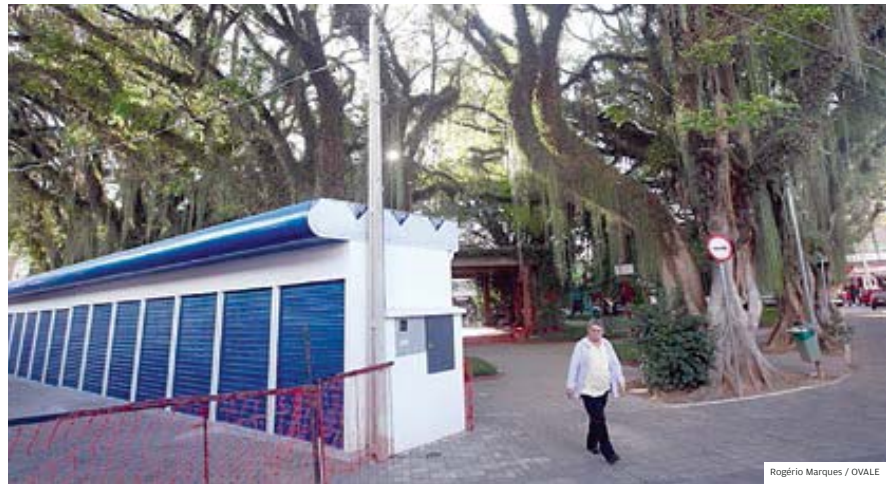
Em obras. Estrutura do camelódromo da Praça do Sapo na tarde de ontem; futuro do local é debatido
